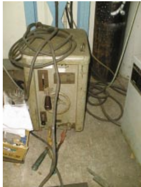
手溶接用の電源(写真)
