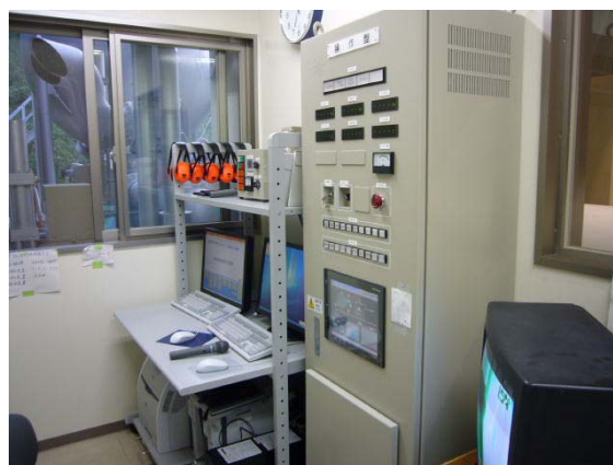
計測室風洞制御盤 Control Room
